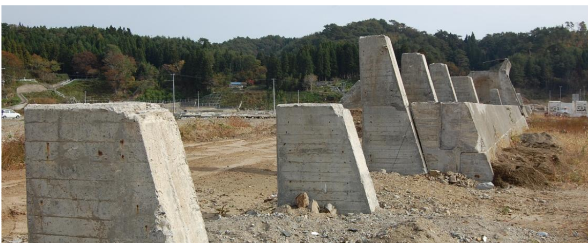
高さ10メートル・総延長約2.5キロに及ぶ「世界一」の防潮堤。「津波防災の町」を謳う宮古市田老地区（旧田老町）のシンボルだったが、20メートルもの津波によって破壊された。平成23年10月30日撮影。
